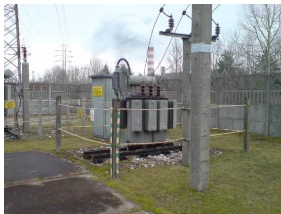
Rys. 9. Wyłączenie transformatora 15/0,4 kV z przestrzeni pracy w pobliżu napięcia – oznakowane ogrodzenie (fot. Karol Zajdler)
