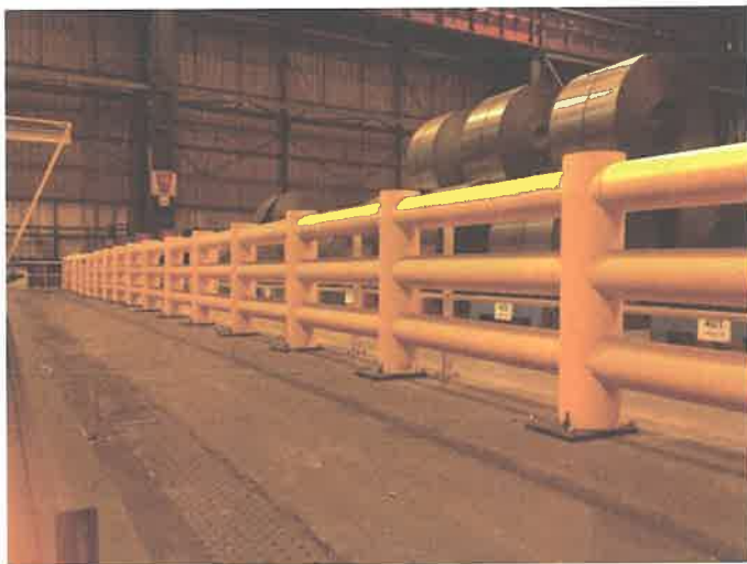
Rys. 2-24. Oddzielenie strefy pracy od strefy ruchu pojazdów za pomocą bariery fizycznej z tworzywa sztucznego (ilustracja dzięki uprzejmości firmy Evergrip sp. z o.o., Warszawa)
